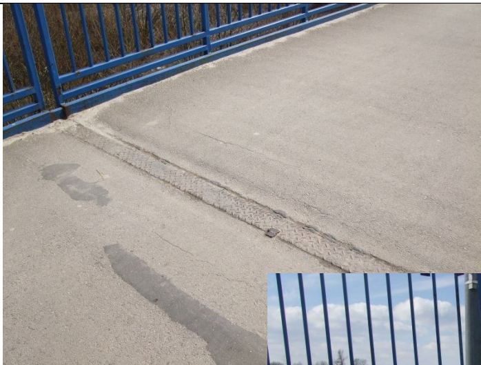
Widoczne nieszczelne dylatacje; przęsłowa i podporowa
