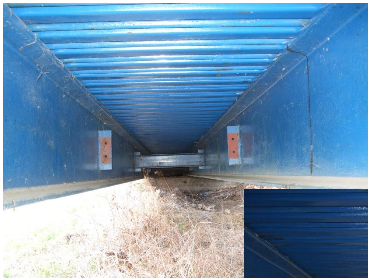
Widoczne brakujące poprzecznice stalowe w przęśle IX
